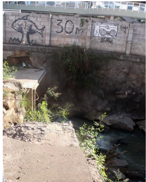
Figura 4 - Situação atual da margem do rio, com as construções irregulares.
