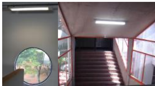
Figura 17. Desperdício de energia elétrica.
